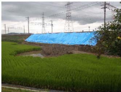
豪雨による鉄道盛土崩壊
