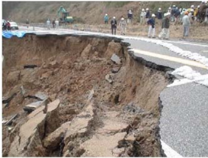
地震による道路地盛土崩壊
