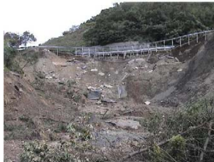
豪雨による道路盛土崩壊
