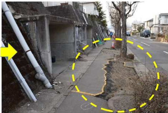
2022年3月16日の福島県沖地震で被災 ※歩道部が連続して隆起により変状
