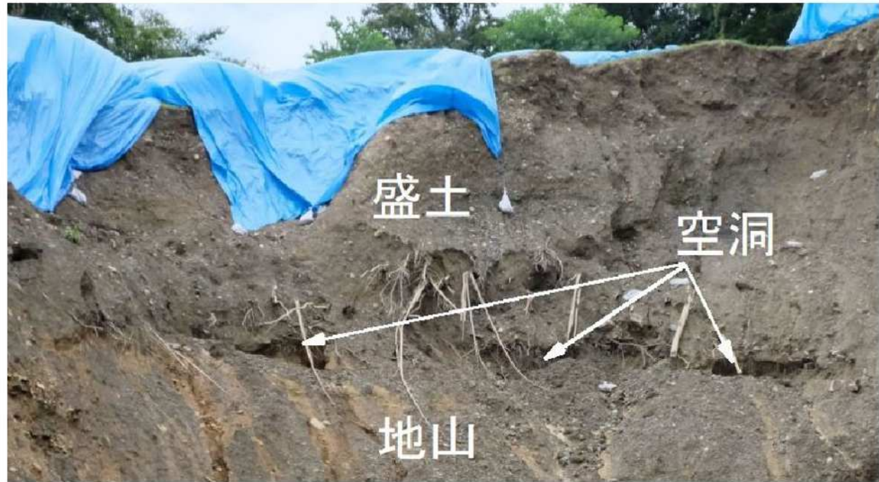
写真1 盛土と地山との境界の空洞 (2021年滋賀県湖西道路で釜井俊孝撮影)
