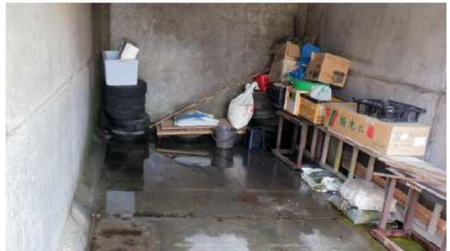
写真3 全てのガレージの奥に水が溜まった
