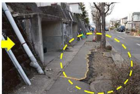
2022年3月16日の福島県沖地震で被災 ※歩道部が連続して隆起により変状
