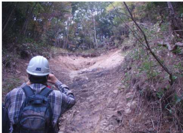
図 1 2010 年庄原災害の崩壊跡 直径 10m の土が吹き飛ばされて流失した
