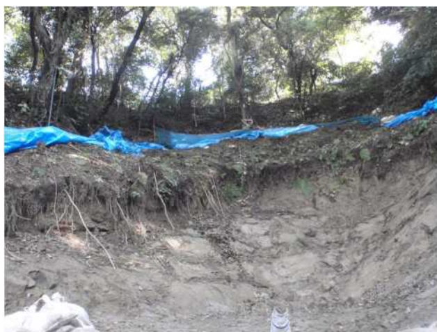
図 2 2012 年京急脱線の原因となった崩壊跡 直径 10m の土と水が斜面を下って線路に流れ込み、その土砂に電車が乗り上げた
