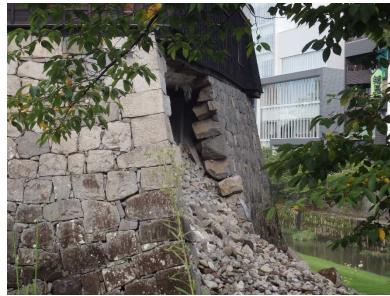
石積み擁壁崩壊
