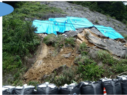
モルタル吹付斜面の崩壊
