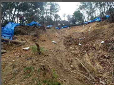
崩壊箇所状況
