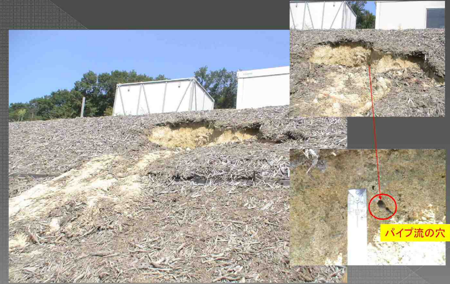
パイプ流の被圧水圧で爆裂した穴
