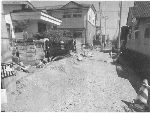
写真-6 仙台市泉区南光台の地表変状(その1)
