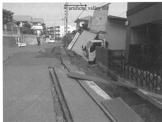
写真-2 仙台市青葉区折立地区における引張亀裂状況
