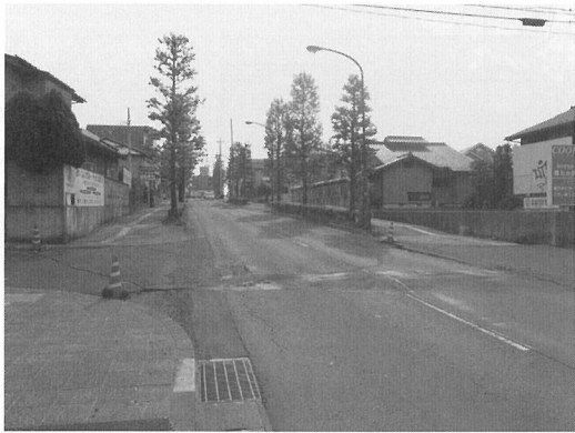
写真-7 仙台市泉区南光台の地表変状(その2)
