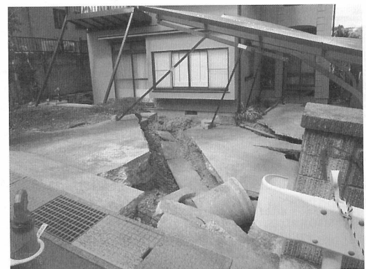
写真-9 仙台市太白区緑ヶ丘4丁目の被害状況
