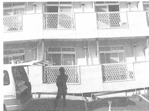
写真-5 アパートの折れ曲がり (松が丘)
