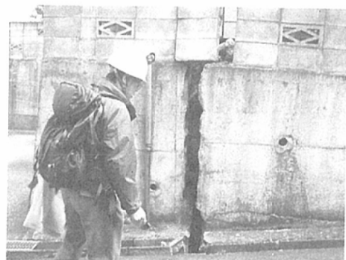
写真-2 盛土ユニット境界部の引張クラック (緑ヶ丘4丁目)
