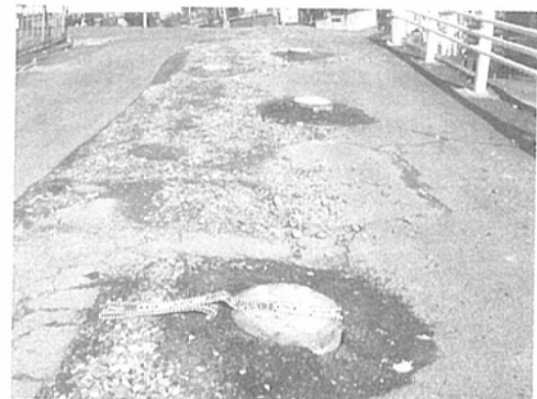
写真-1 沈下により道路に突きだした抑止杭 (緑ヶ丘3丁目)
