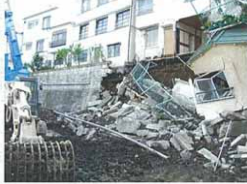
工事のわずかな振動で崩壊 (2004年4月2日)
