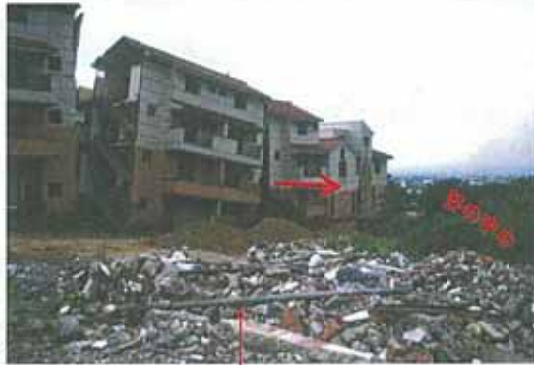
この部分にあった建物は倒壊
