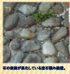
石の表面が風化している空石積み擁壁。
