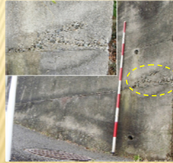
ジャンカの認められるコンクリート擁壁。
