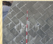
クラックからの白色生成物が多く見られる擁壁
