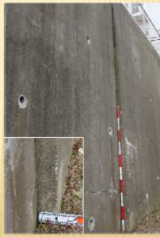
10cm程度の大幅な水平移動が認められるコンクリート擁壁
