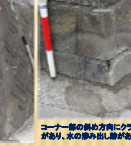
コーナー部の締め方向にクラックがあり、水の浸入がみられる。油断がある場合は、角部を修理する。
