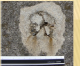
コンクリート擁壁に発生した白華現象
