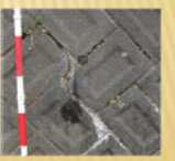
クラックから白色生成物が折出し、雨水もみられる。
