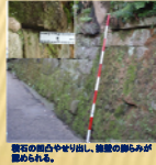
空石の崩れややり出し、隙間の崩れなどが認められる。
