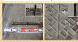
上下の段差を伴うコンクリート擁壁の開き
