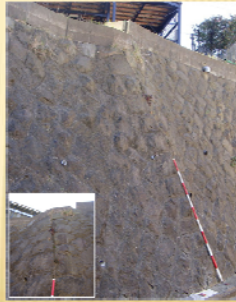
目地の部分がふくらんでいる練石積み擁壁。
