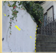
明らかに前傾しているコンクリート擁壁。
