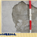
鉄壁に不貫通なクラックが確認される。
