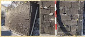
擁壁後面がふくらんでおり、積石が押きだしている部分が見られる。
