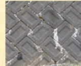
壁面の表面層から白色生成物が折出しており、その厚さが1cmである。
