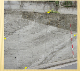
コールドジョイントの認められるコンクリート擁壁。
