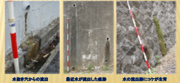
水抜き穴からの露出
