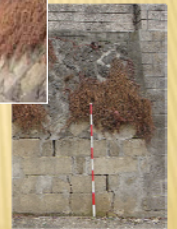
開口クラックや石積みのみくらみなどの変状が顕著で危険な状態にある擁壁。
