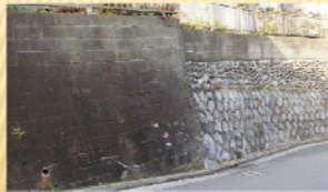
写真左側の鉄筋ブロック積み擁壁は明らかに後傾しており、写真右側の練石積み擁壁は、やや後傾している事例。
