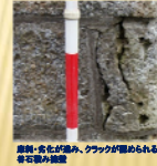
風化・劣化が進み、クラックが認められる大谷石積み擁壁。
