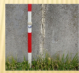
隙間の目地から折出した白色生成物
